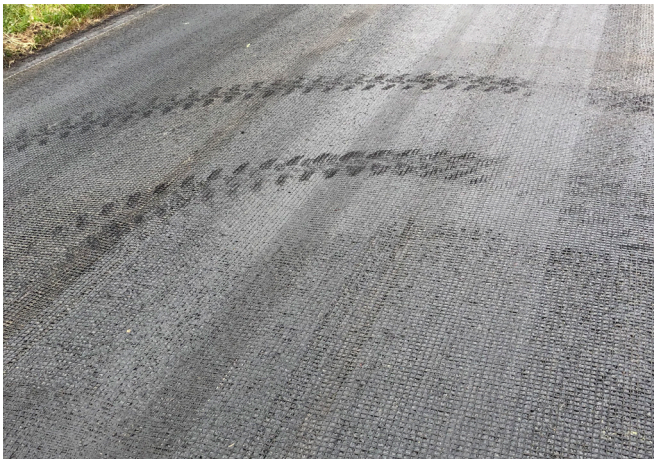
Dækspor synlige på toppen af gitteret
