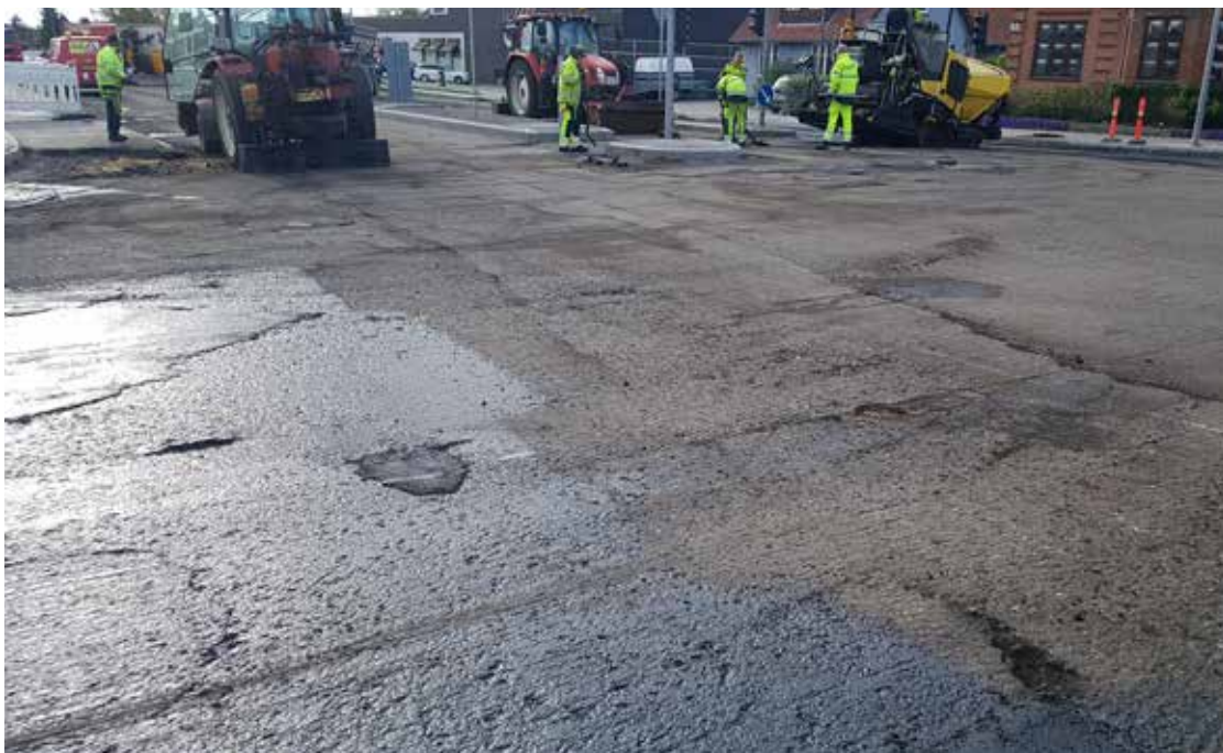
Belægningstilstand efter fræsning, revnet og uhomogent
