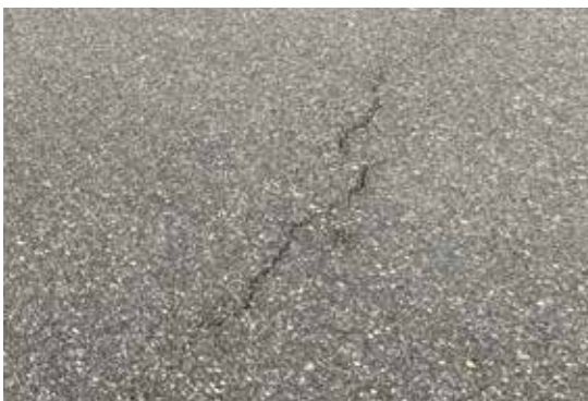
Revner på stikveje observeret i 2022
