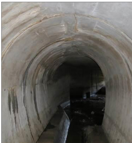
▲ Kanalens tilstand, før renovering
